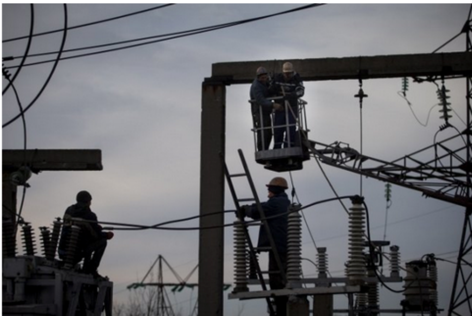
Des cyberhackers pourraient être à l'origine de la nouvelle panne qui a touché le réseau électrique de l'Ukraine le week-end dernier. (Crédit D.R.)
