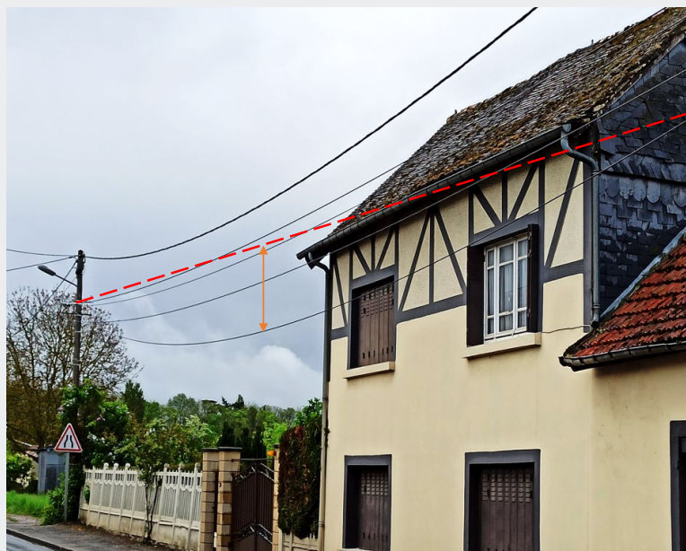
Affaissement ou décrochage de la portée de câbles
