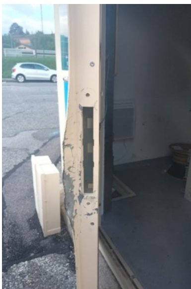
Porte fracturée d'un local NRO à La Roche-sur-Foron
