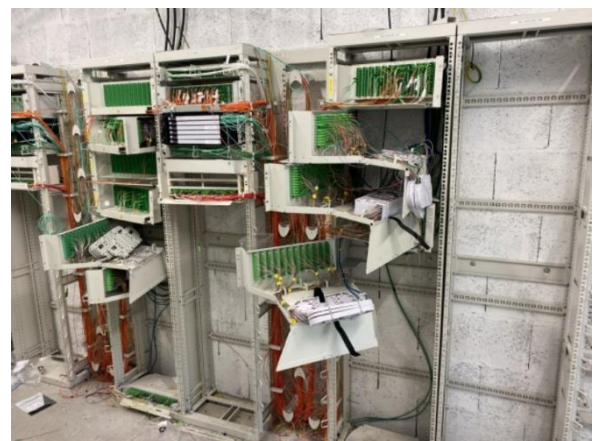
Équipements dégradés dans un local NRO à Neydens
